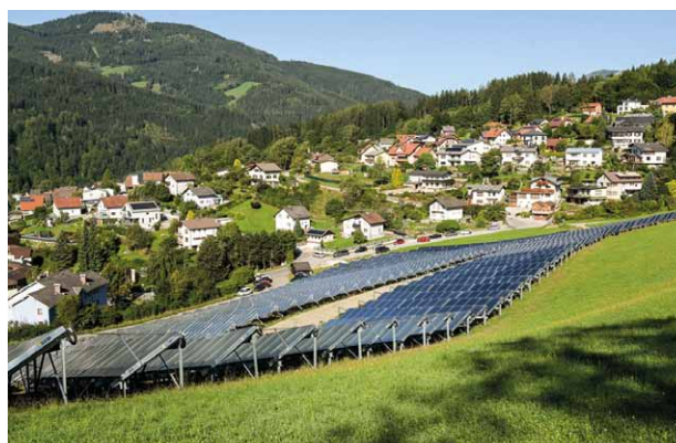
Die Solarthermieanlage auf der Mayerhoferwiese mit rd. 7.000 m 2 Kollektorfläche
