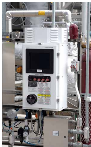
Links: Wasserstoff-Beimischung mit Promass Q für H 2 -Durchflussmessung und Rxn5 Raman Analyse für H 2 -Anteil im Erdgas
