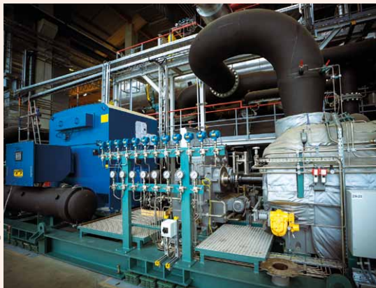
Großwärmepumpe ebswien Kläranlage in Simmering
