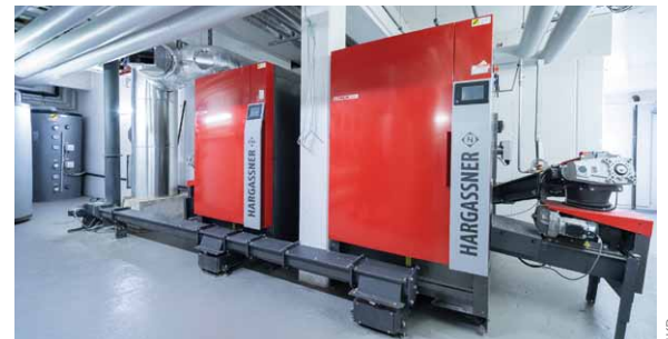
Innsbruck: Umrüstung des IKB-Standorts Richard-Berger-Straße auf Biomasse: Die Heizanlage im Keller erstrahlt in neuem Glanz. Nun kann CO 2 -neutral geheizt werden.
