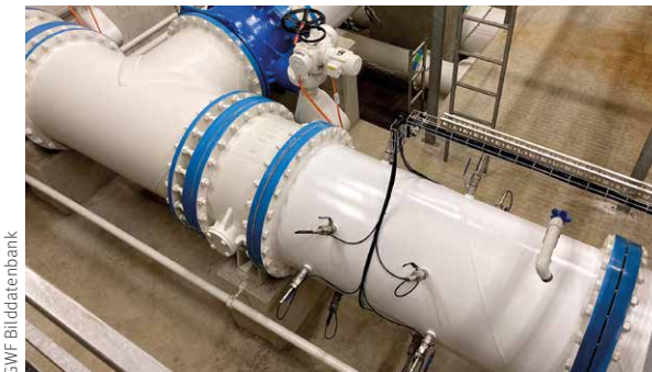
Abb. 3 Insertion Durchflussmessgerät in einer Wasserversorgung (6 Pfade)
