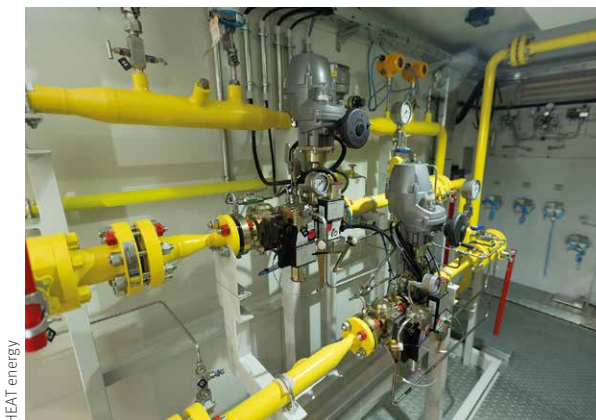
Abb. 1 Mengenregelung elektrisch mit HEAT CE15-Reglern
